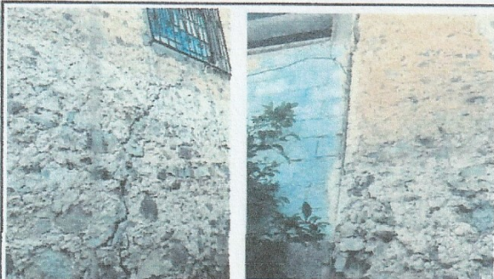
Foto 3: las paredes se encuentran agrietadas aumentando el peligro con una posibilidad de caerse y poniendo en riesgo la vida de los niños a la hora de recreo
