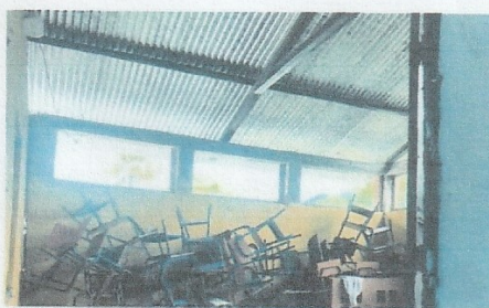
Foto 4: el techo se encuentra en mal estado lo cual es necesario cambiarlo
