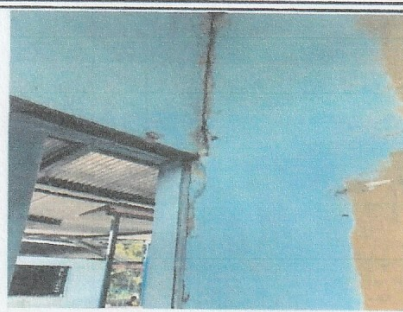
Foto 2: las paredes por dentro se encuentra abiertas y no es adecuado para poder ser utilizada, también parte de la puerta no es tan segura y tiende a caerse
