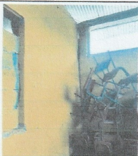
Foto 1: Las paredes de las esquinas están ya casi despegadas y corren riesgo de caer con un fuerte sismo
